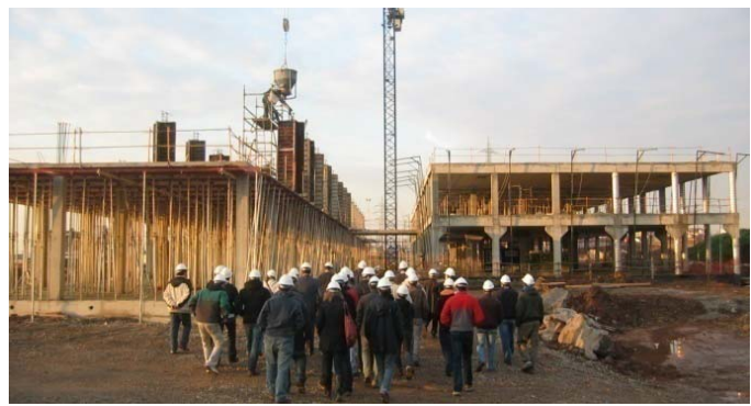
Visita de los alumnos del Máster a las obras del nuevo parque de bomberos del Ayuntamiento de Santander
